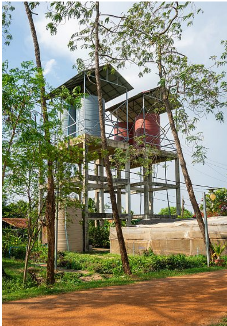
Pumpen befördern das Trinkwasser für den Campus aus 180 Metern Tiefe an die Oberfläche.
